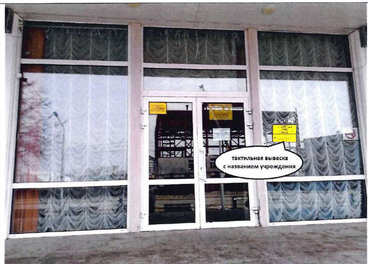
Фото № 10. Фасад МБУ ГДК «Родина», запад. Входная площадка (перед дверью). Дверь входная.
